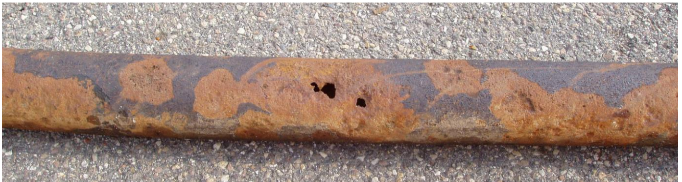
Gussrohr einer Hausanschlussleitung mit starken Korrosionsschäden
