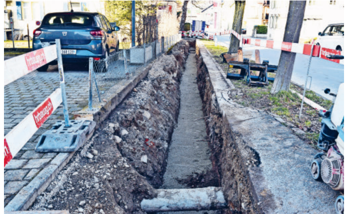
Das Fernwärmenetz wird an das Restaurant Bahnhof und den Gemeindesaal angeschlossen.
