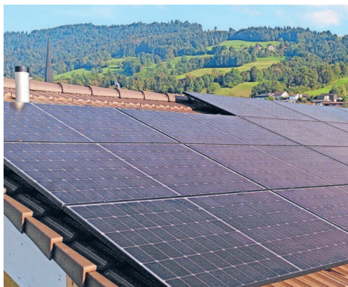
Die neue PV-Anlage im Oberfeld 5 + 7.
