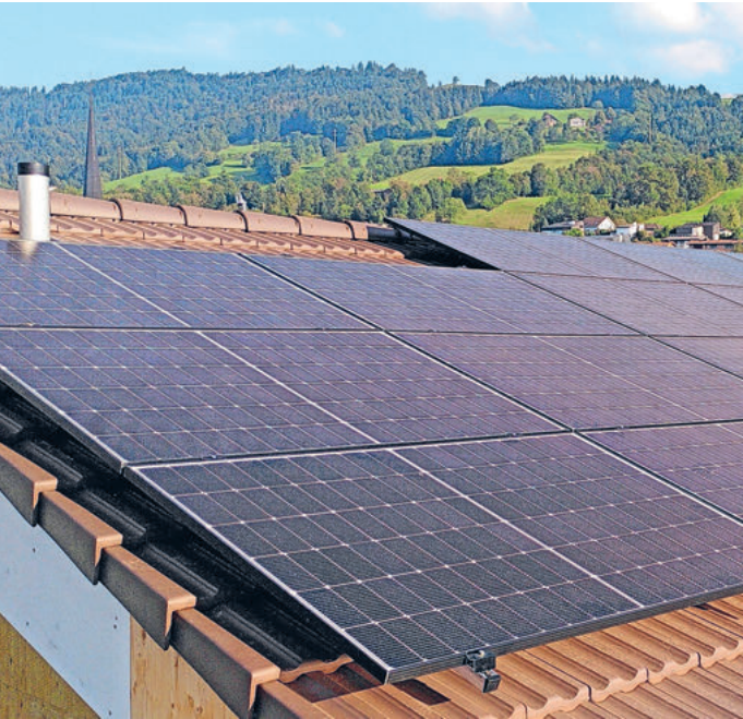
Die neue PV-Anlage im Oberfeld 5 + 7
